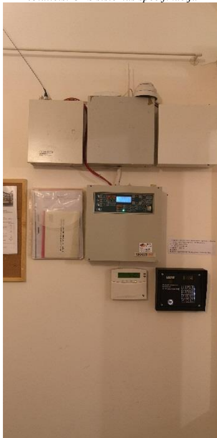
44.attēls. centrālais UAS panelis.
