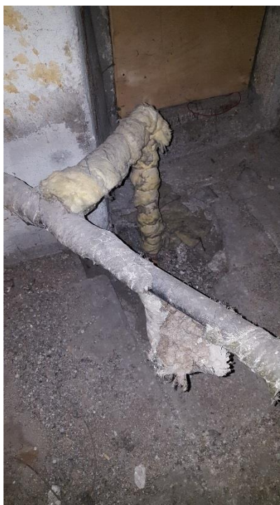
52.attēls. Cauruļvadu siltumizolācija bēniņos ir sliktā stāvoklī.
