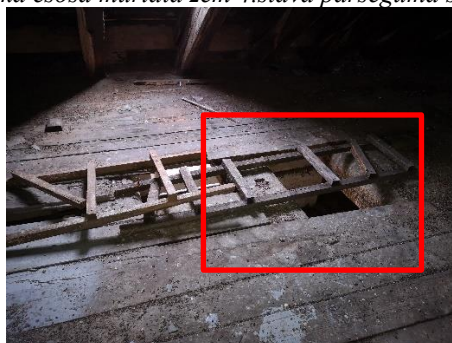
11.e.1.attēls. Bojāta dēļu grīda (caurums)
