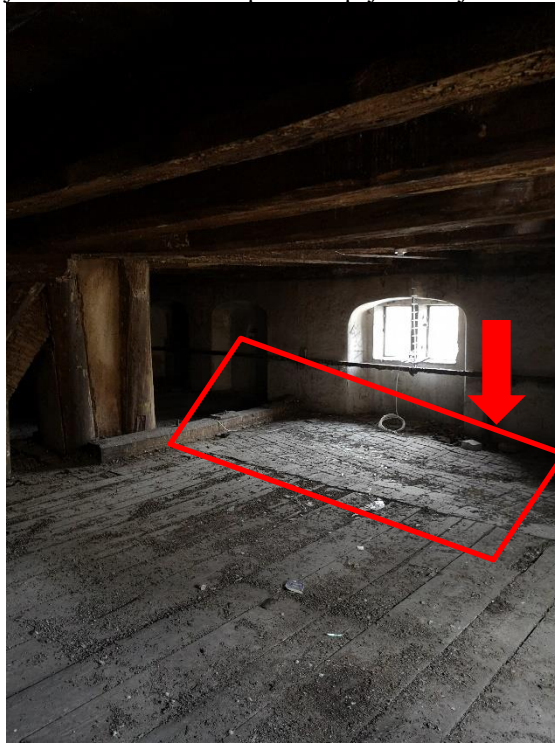
11.a. attēls. Koka dēļu virssegums/ķieģeļu mūra virssegums (redzamas deformācijas).
